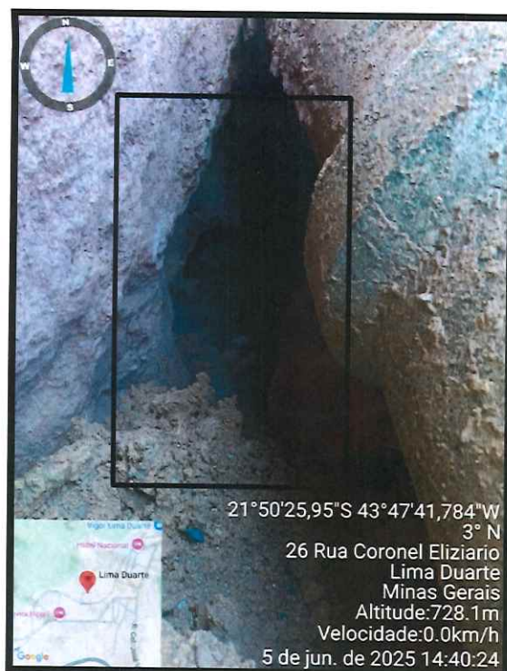
Imagem 05 - Pavimento danificado por erosão interna causada por percolação de águas pluviais.
