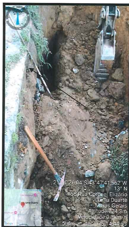
Imagem 03 - Acúmulo de água próximo ao meio-fio, indicando ausência de drenagem superficial adequada.
