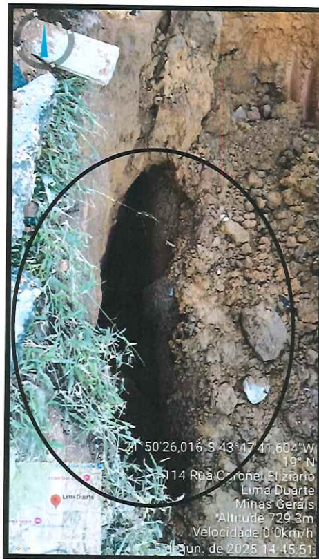
Imagem 01 - Solapamento do pavimento junto à sarjeta, com rebaixamento visível da camada asfáltica.
