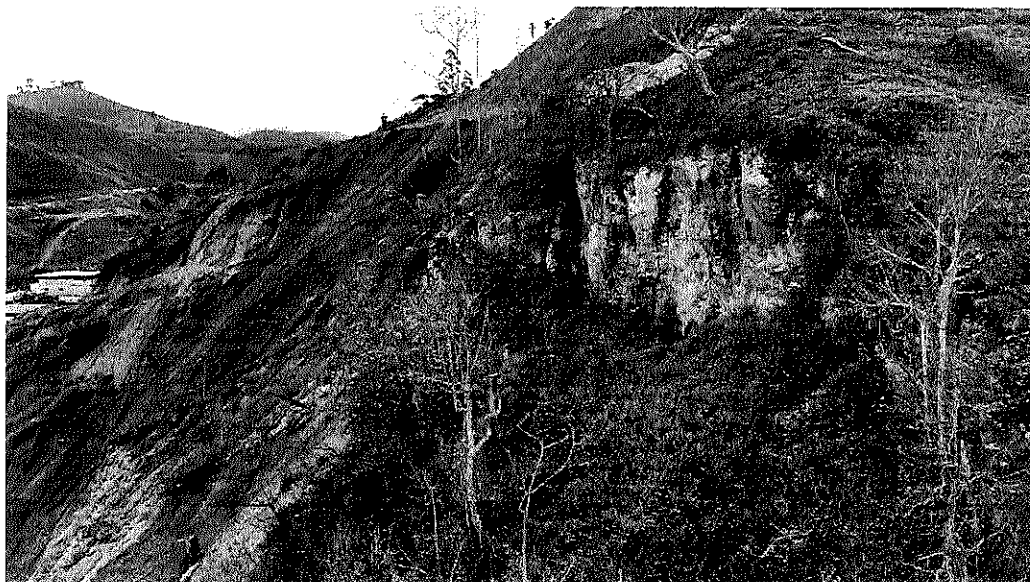
Foto 03: Ilustração da heterogeneidade geológico-geotécnica do talude.
