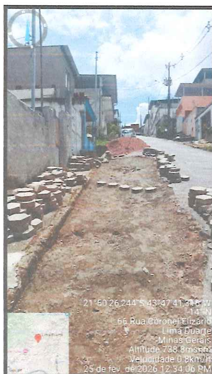
Imagem 12 - Base da via exposta para inspeção e reconstituição provisória após identificação de instabilidade provocada pelo solapamento da galeria pluvial.
