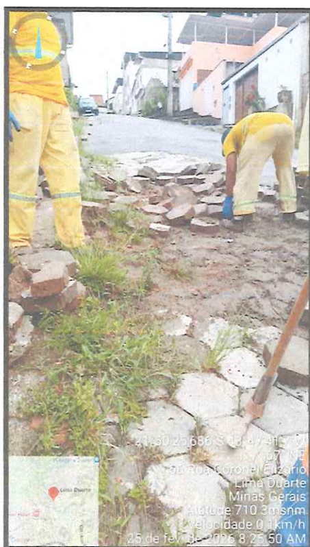
Imagem 10 - Remoção do pavimento intertravado para inspeção da base comprometida e verificação de vazios decorrentes do solapamento da drenagem pluvial.
