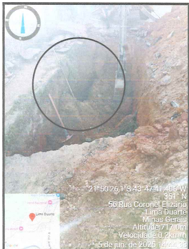
Imagem 06 - Afundamento de trecho do asfalto sugerindo comprometimento de manilha pluvial – Parecer Técnico 14-2025.
